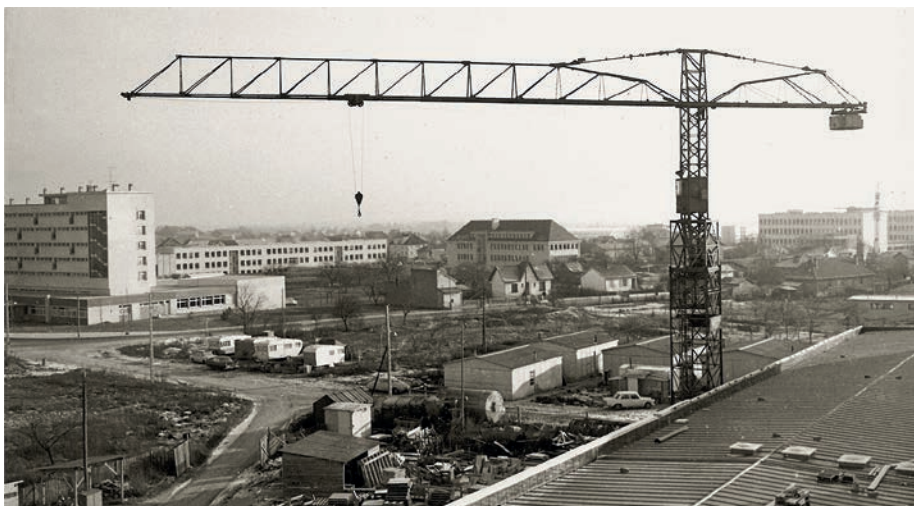
Début du chantier de construction des bâtiments du Centre Inra de Dijon. En arrière-plan, plein centre de la photo, le bâtiment dédié à l'agronomie, premier à sortir de terre sur le site de Dijon-Sully, en 1962.
